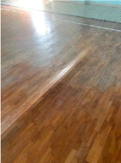
Bukti kerusakan Lapangan
